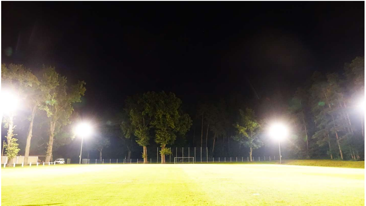
Abb. 5: Flutlichtanlage im Einsatz
